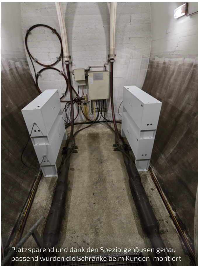
Die Schränke sind bereit für die Auslieferung an den Endkunden
