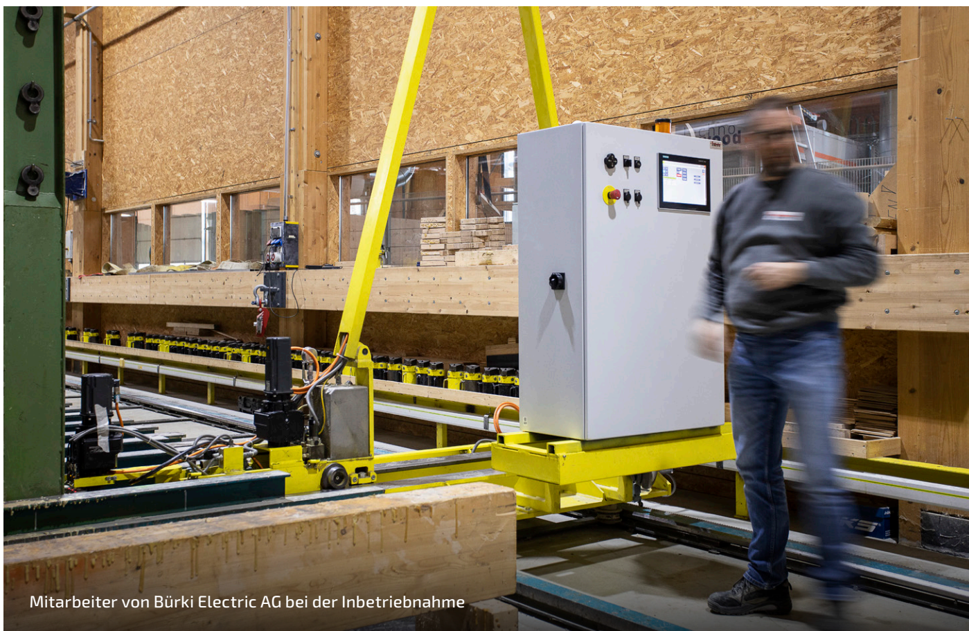
Der neue Schaltschrank auf dem Verstellsschlitten
