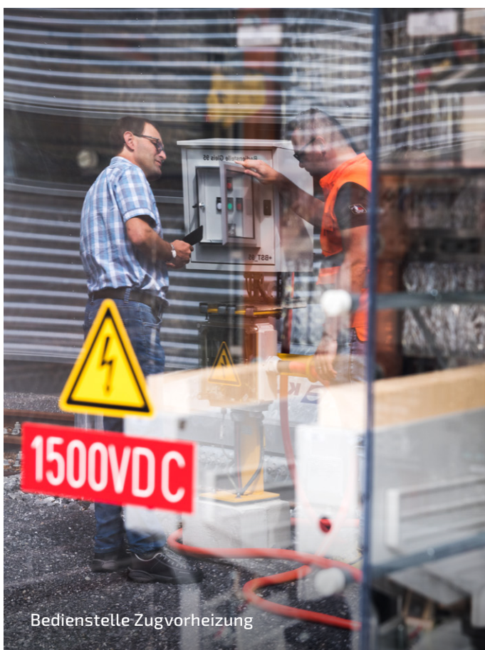
Zentralsteuerschrank zur Fahrleitungssteuerung
