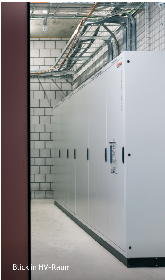
Einspeiseschalter und NH-Abgänge
