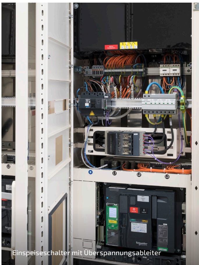
Trafo-Raum mit NSHV
