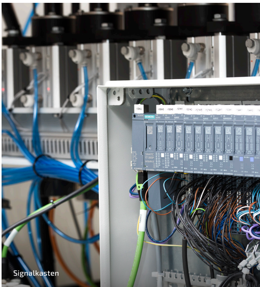
Antriebsregler und Aufgabestation
