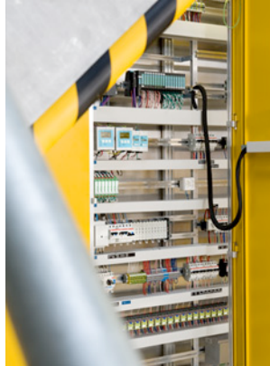
Blick in einen Steuerungsschrank
